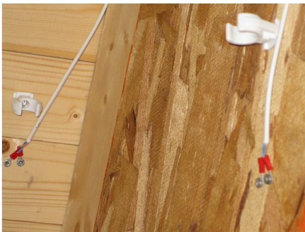
Følere er monteret mange steder i konstruktionen
